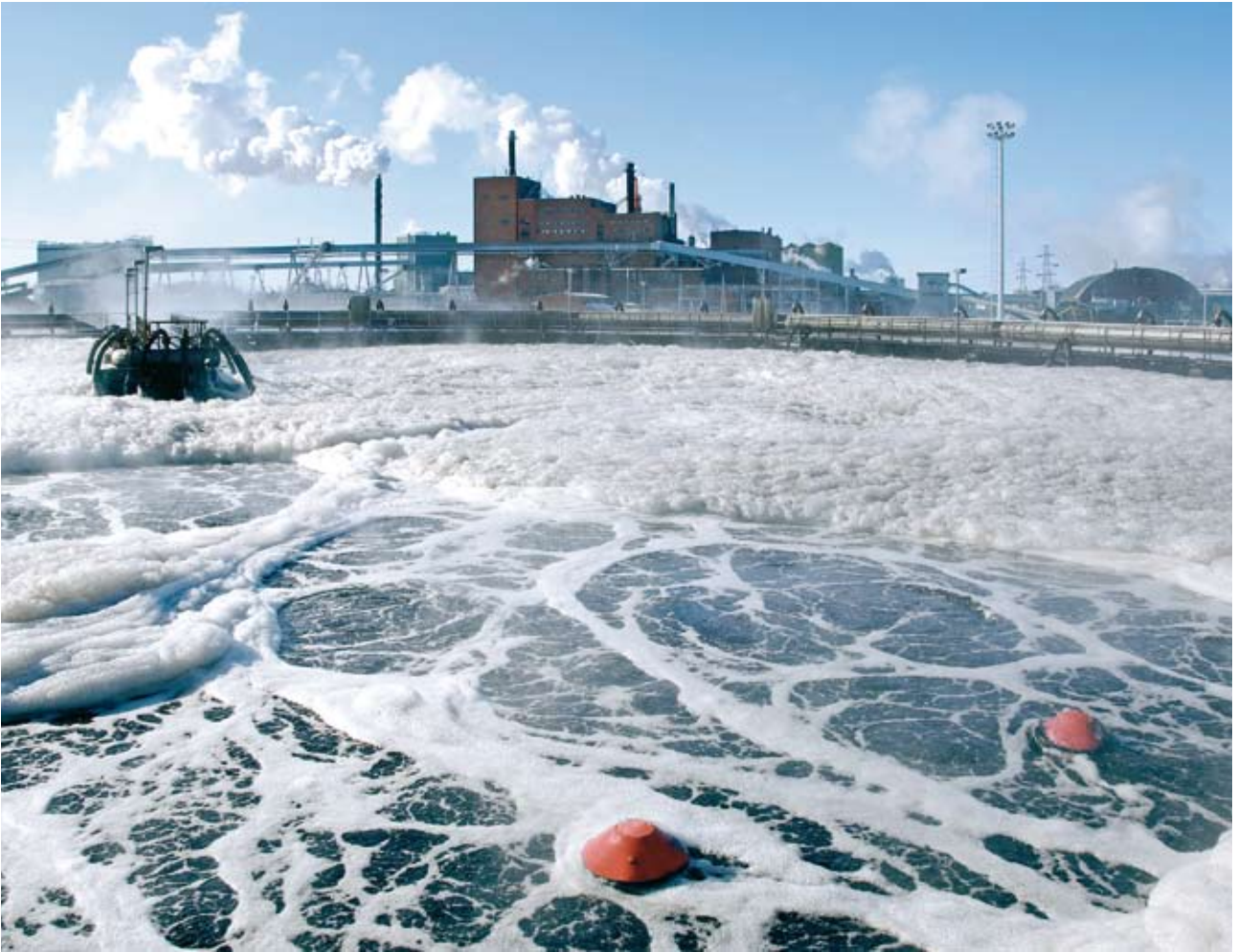
Biologinen jäteveden puhdistamo.
