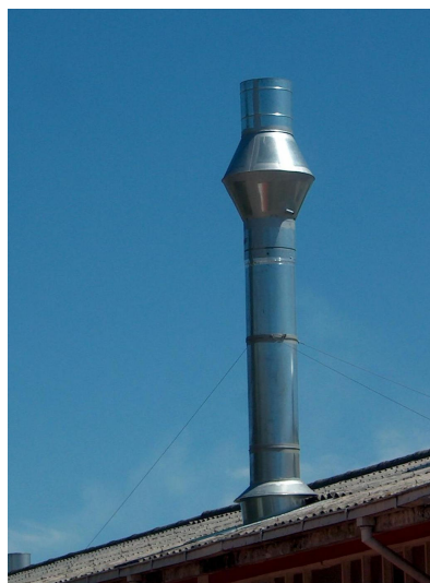
Figura 14 – Chaminé das estufas de secagem de fio
