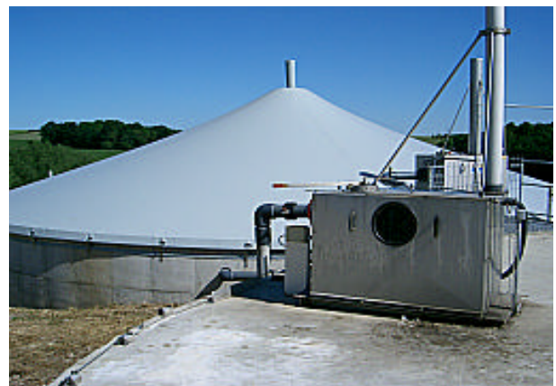
Abb. 8: Fermenterbecken der Biogasanlage
