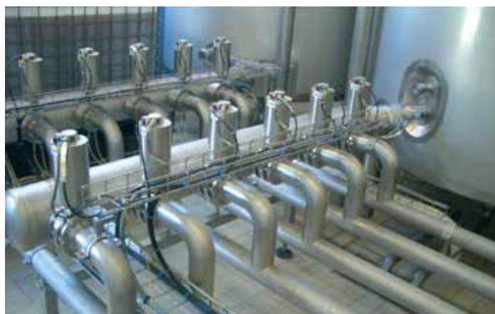
Automatische Absperrventile der neuen vollautomatischen Reinigungsanlage in Pfaffenhofen.
