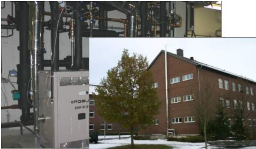
Wohngebäude Kaserne – Volkach, Germany, 140 kW heat
